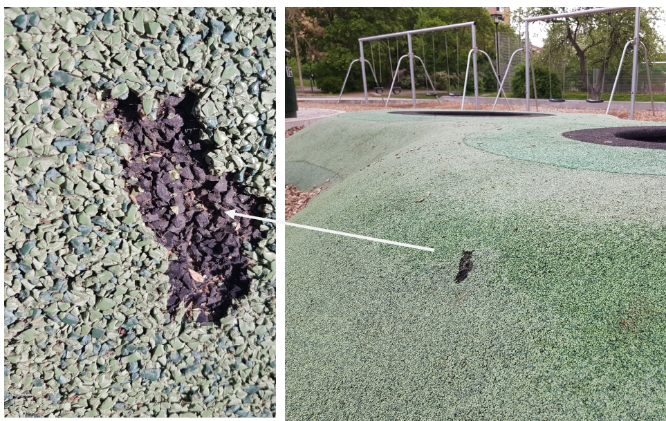
Figur 3. Fallskydd där det översta lagret skadats och baslagret exponeras. Foto Åsa Jarsèn
